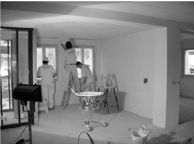
Abrieb der Wände
