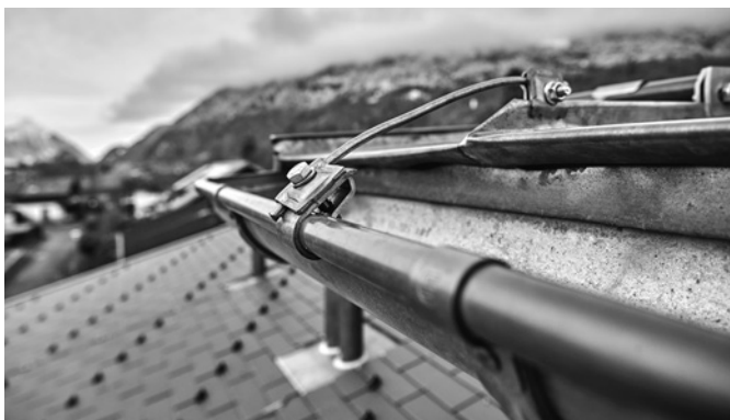
Blitzschutzsystem auf einem Schrägdach.
