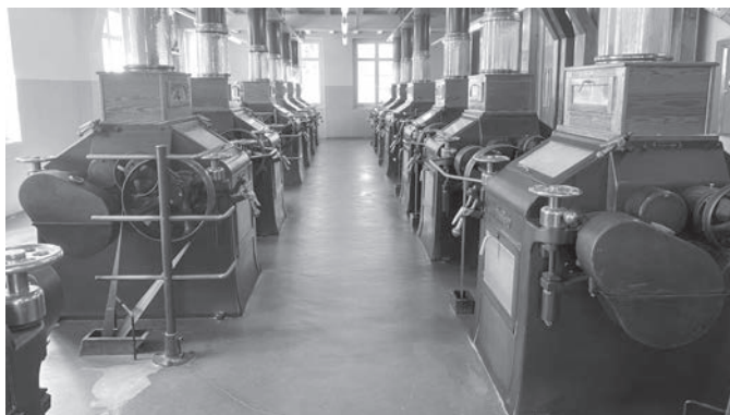
In der Mühle gibt es insgesamt 17 Walzenstühlen.
