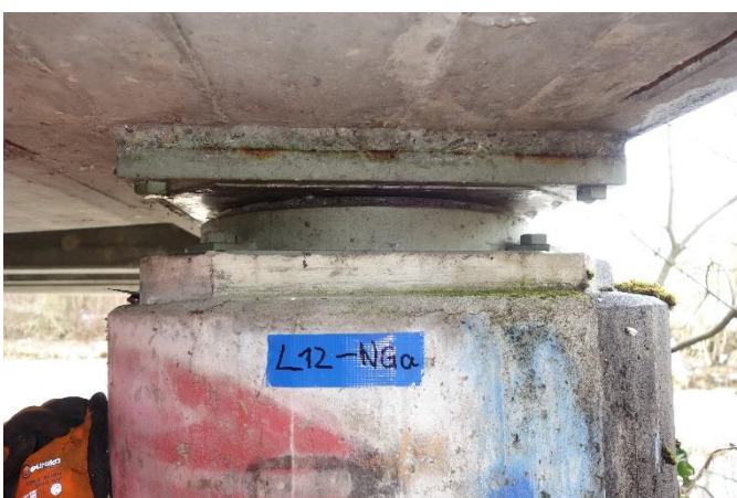
Abb. 16: L12 – NGa: Korrosion an Gleitplatte
