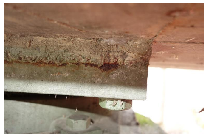
Abb. 179: L12 – NGa: Korrosion an Gleitplatte
