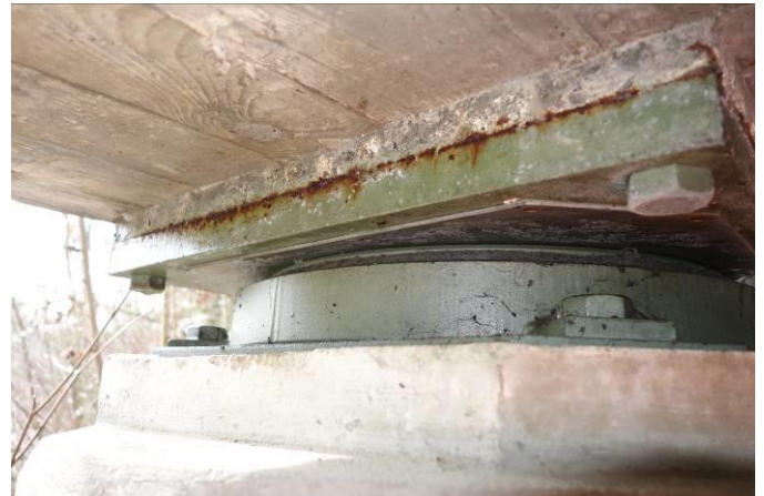
Abb. 9: L5 – NGa: Korrosion an Gleitplatte
