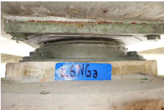
Abb. 10: L6 – NGa: Korrosion an Gleitplatte
