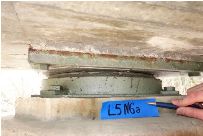
Abb. 8: L5 – NGa: Korrosion an Gleitplatte
