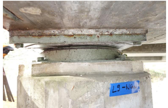
Abb. 15: L9 – NGa: Korrosion an Gleitplatte
