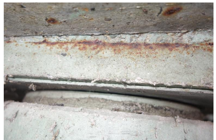
Abb. 20: L7 – NGa: Korrosion an Gleitplatte
