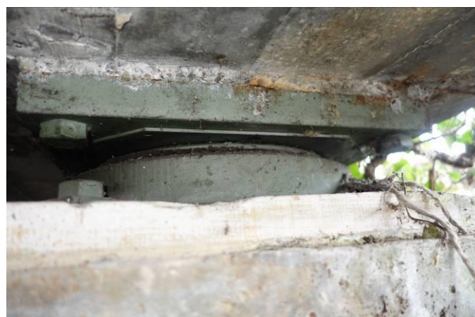
Abb. 7: L4 – NGa Korrosion an Gleitplatte
