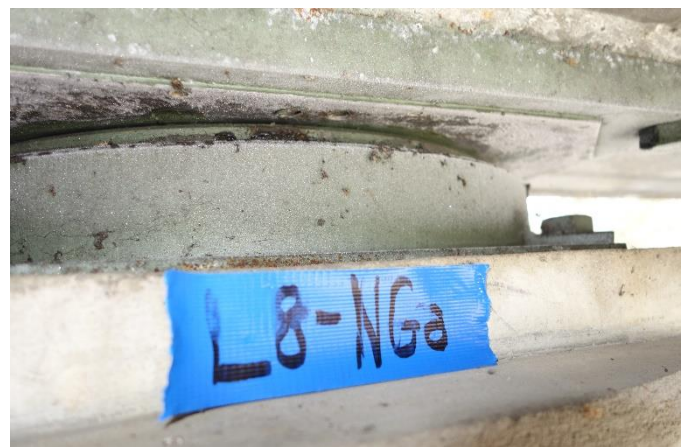
Abb. 13: L8 – NGa: Zustand allgemein i.O. (oberflächlich gefrorenes Tauwasser)
