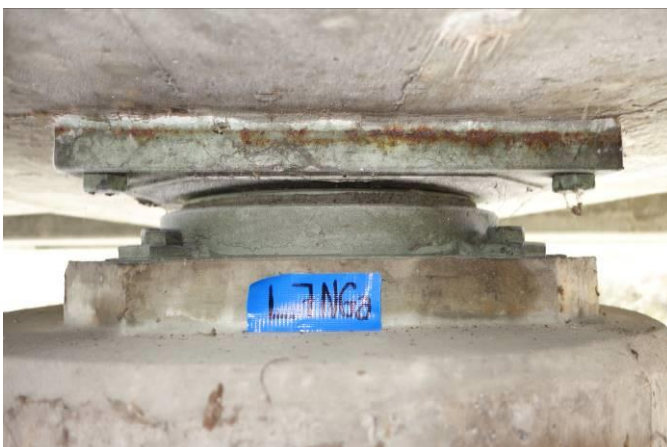
Abb. 12: L7 – NGa: Korrosion an Gleitplatte (oberflächlich gefrorenes Tauwasser)
