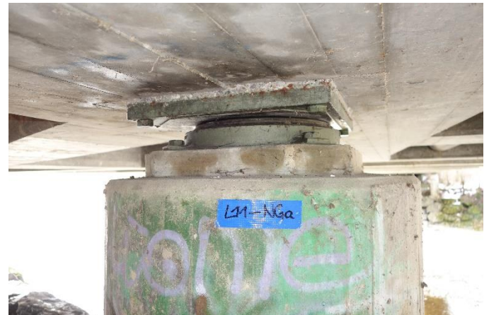
Abb. 157: L11 – NGa – Lager seitlich verschoben, jedoch noch genügend Reserve des Gleitweges vorhanden
