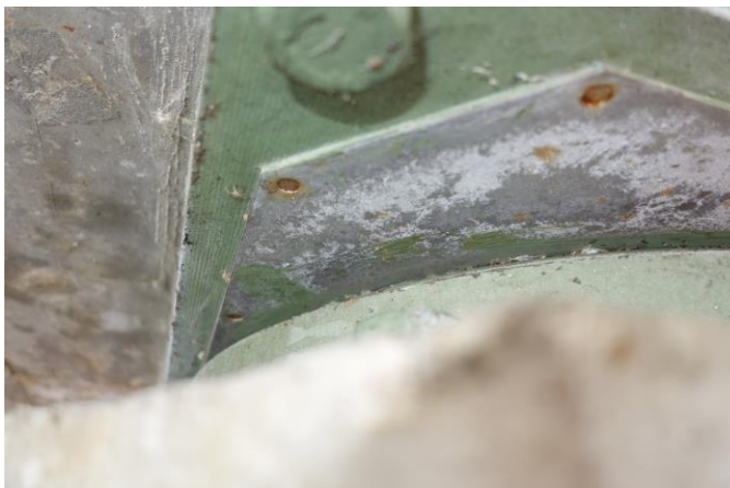
Abb. 146: L9 – NGa – Korrosion an Anschlussstellen des Gleitblechs
