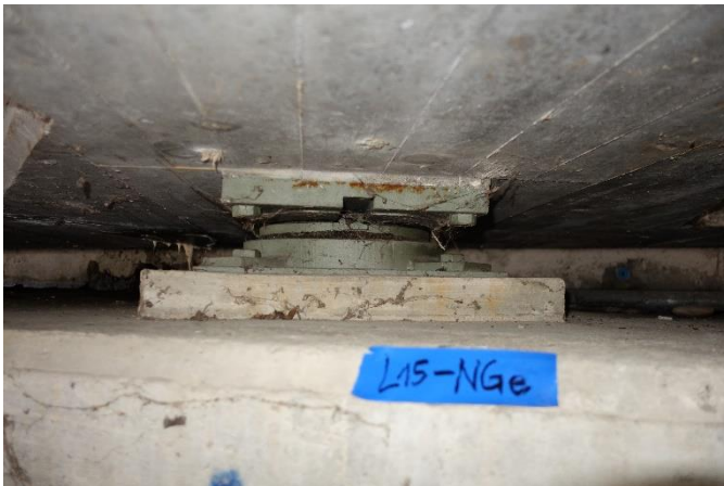
Abb. 2218: L15 – NGe: Korrosion an Gleitplatte
