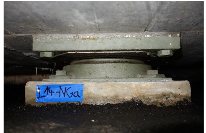
Abb. 21: L14 – NGa: Korrosion an Gleitplatte
