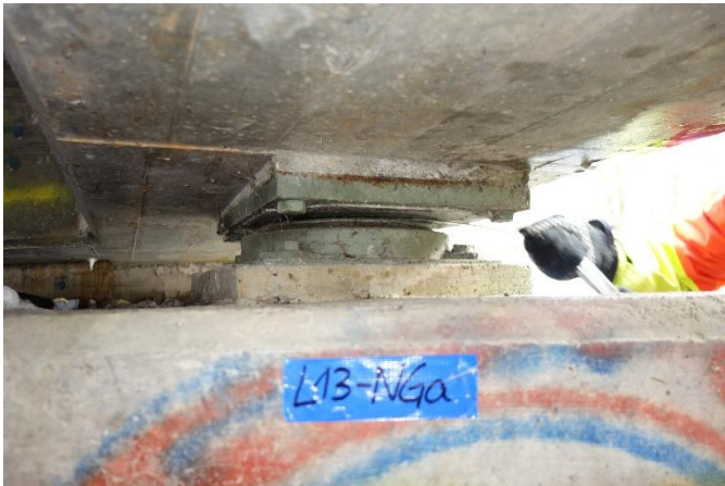
Abb. 20: L13 – NGa: Korrosion an Gleitplatte
