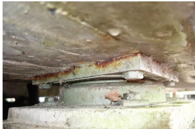
Abb. 3: L1 – NGa Korrosion an Gleitplatte
