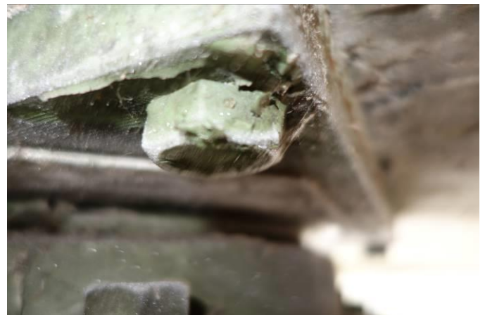
Abb. 11: L6 – NGa Abblättern des Korrosionsschutzes
