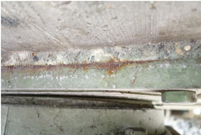
Abb. 14: L8 – NGa: Korrosion an Gleitplatte
