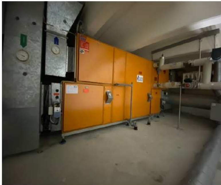
Lüftungsanlagen im MZG
