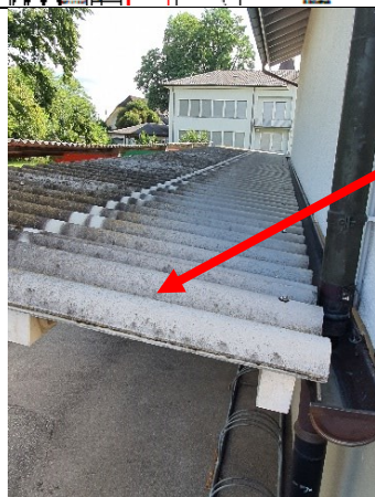
Asbest-Befund! Velounterstand nordseitig Turnhalle
