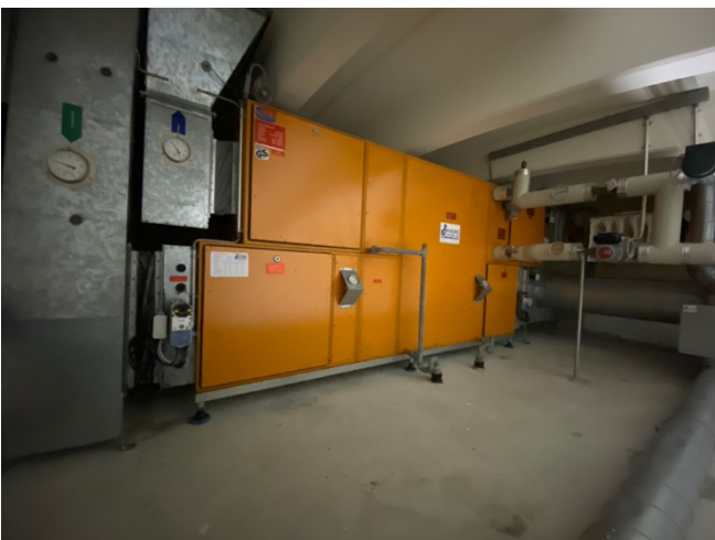
Lüftung Garderobe MZH
